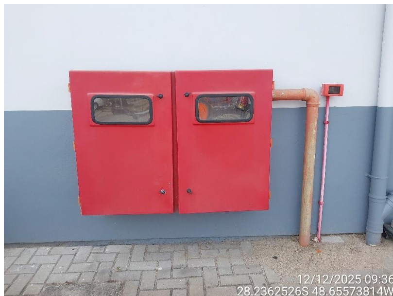
Figura 15 Exemplo de Acesso ao Sistema de Combate a Incêndio
