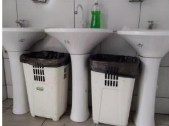
- Lixeira alocada ao lado da pia do banheiro.
