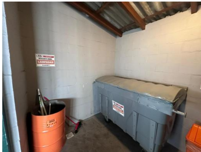
Visão Interna da Central de Resíduos – Classe 1 – Separação, Identificação, piso impermeável.
