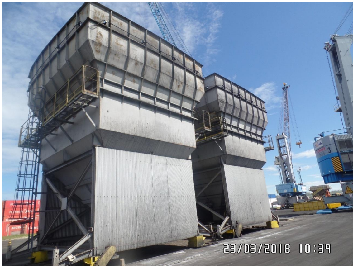
Funis para descarga de coque sobre a TC1 Fonte: Autores (2018)
