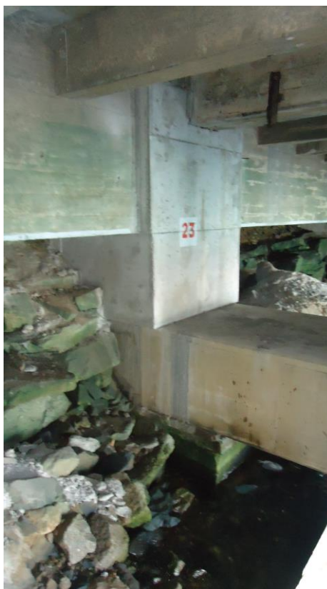
Figura 14 - Evidências de tentativas de estabilização da base do enrocamento
