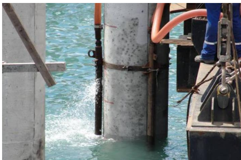
Figura 4 - Tubo que passa a água pressurizada
