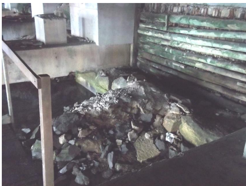
Figura 11 - Estrutura de contenção antiga e tentativa de estabilização da base em enrocamento
