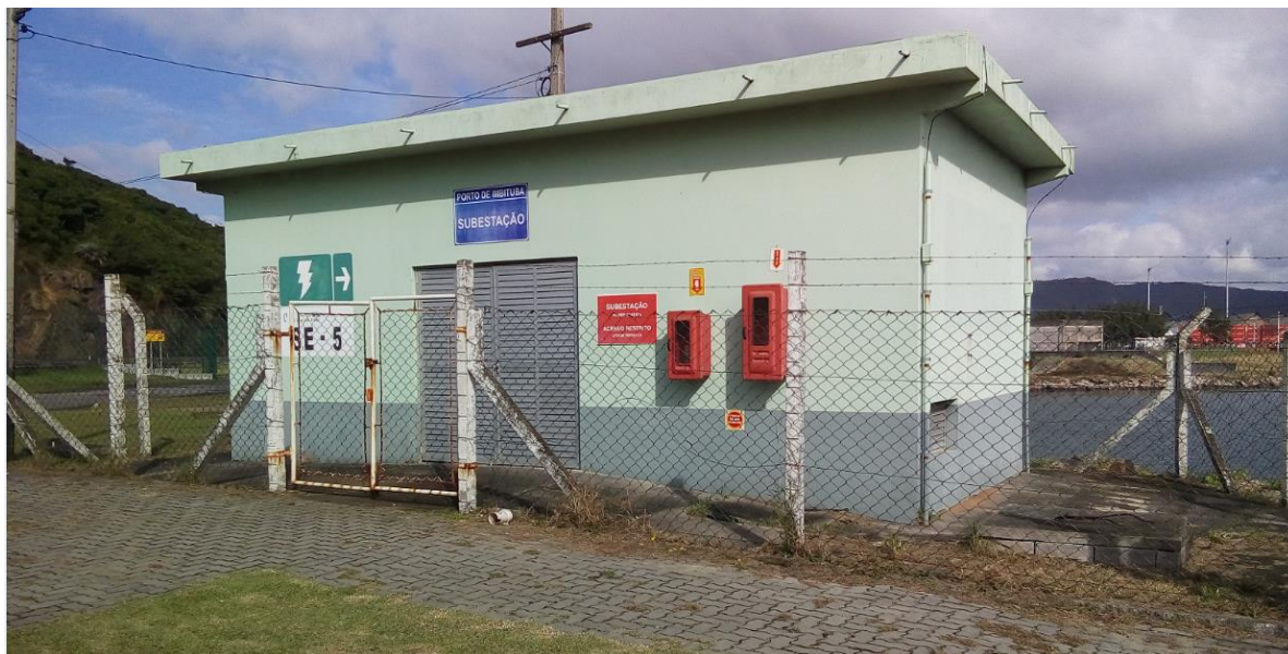
Figura 4 - Subestação 05, Porto de Imbituba.
