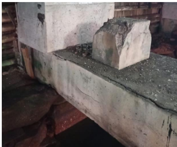
Figura 18- Trincas em elementos estrutural Cais 1
