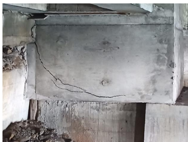
Figura 17 - Trincas em elemento estrutural Cais 1
