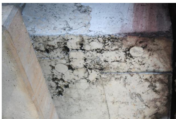
Figura 11- Concreto com segregação aparente no Cais 2.
