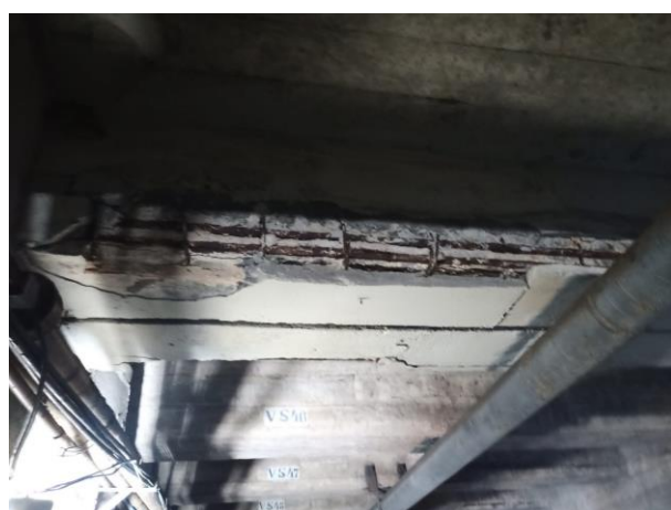
Figura 16- Corrosão de armadura Cais 1
