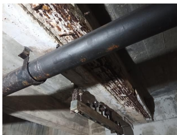
Figura 22- Armadura exposta Cais 1.
