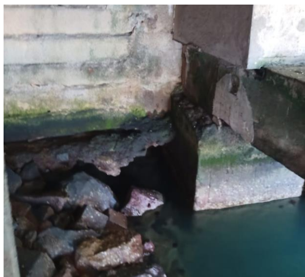
Figura 20- Pequenas Cavernas próximo a elementos estruturais no Cais 1
