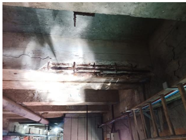
Figura 21- Armadura exposta Cais 1.
