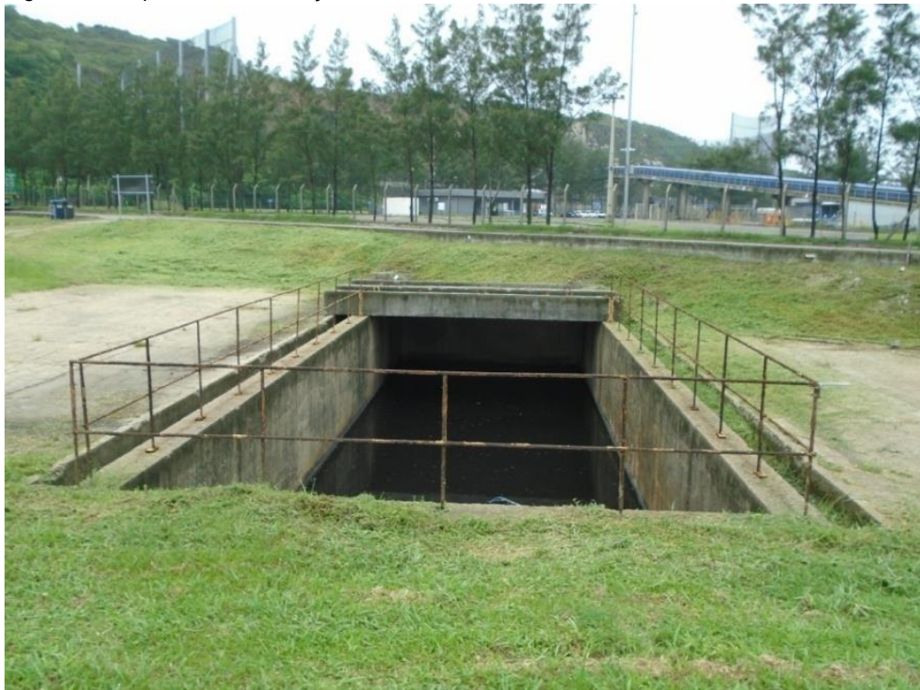
Figura 1: Tanque de Sedimentação 02
