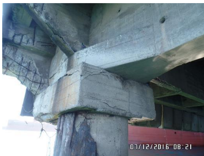
Figura 02 – Pilar do Cais 03 com trincas e viga com armadura exposta
