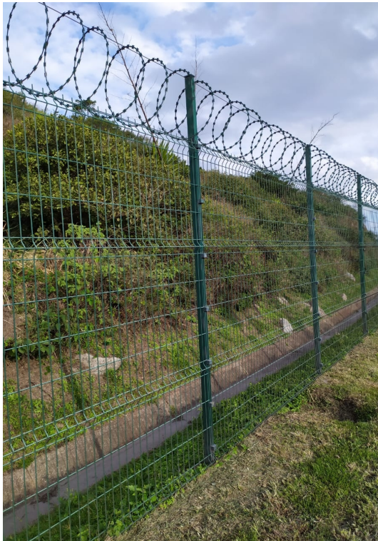
Figura 09 – Concertinas instaladas na SCPAR Porto de Imbituba
