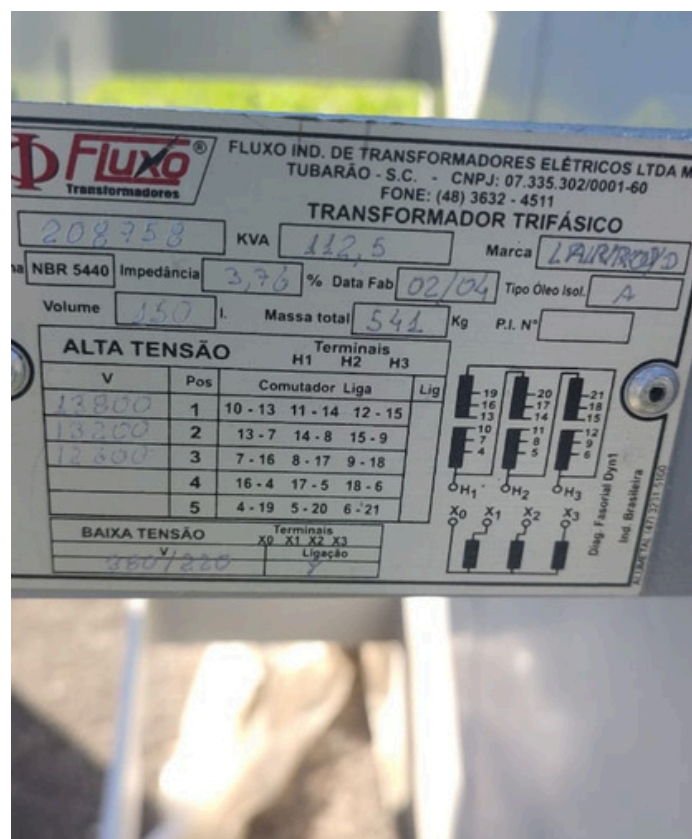
Foto 7 - Placa do transformador instalado
