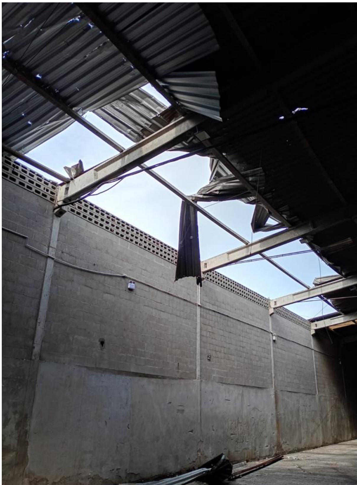
Figura 16 – Avarias na cobertura do Armazém 6
