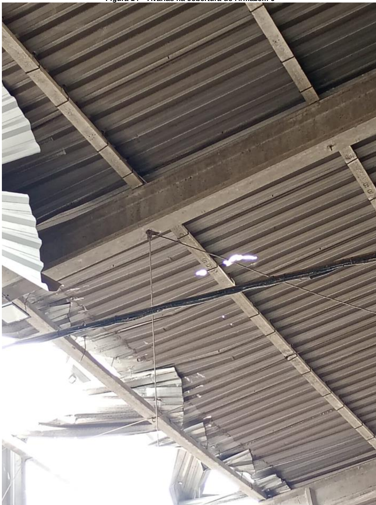
Figura 14 – Avarias na cobertura do Armazém 6
