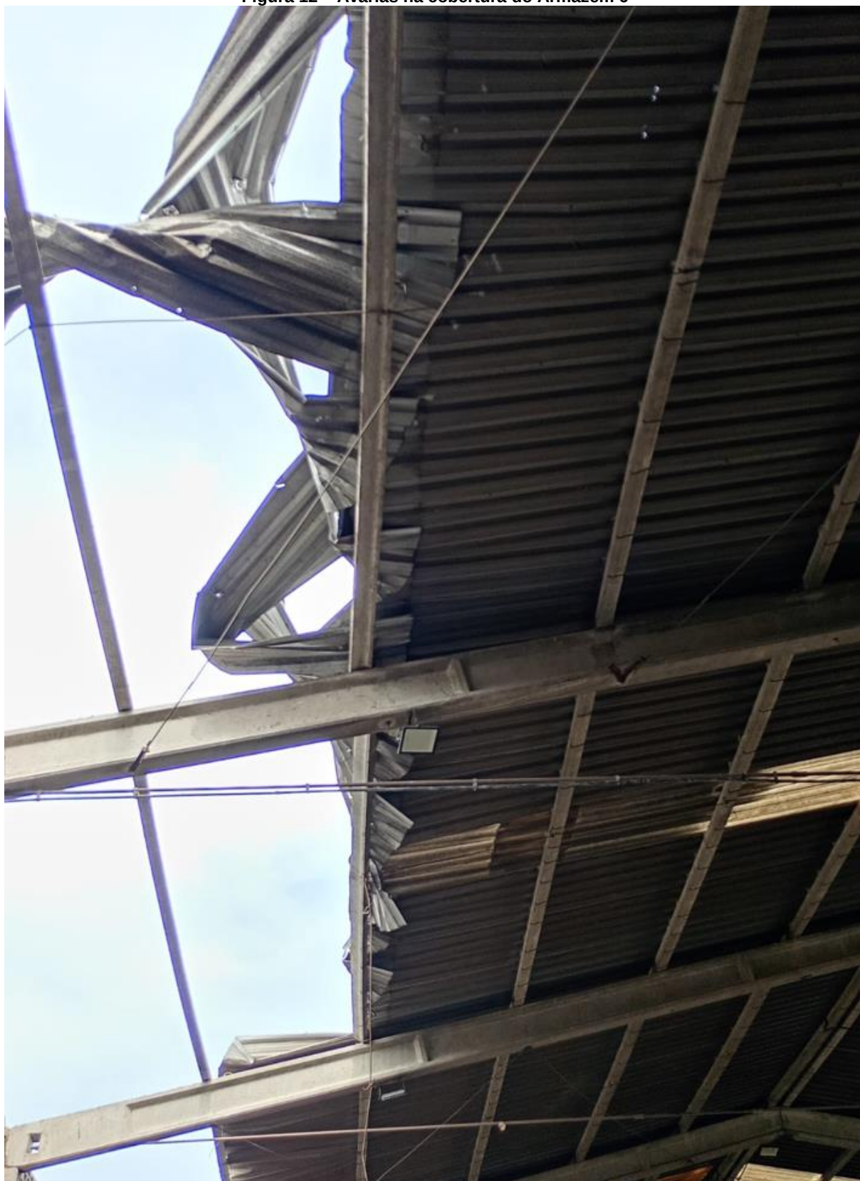
Figura 12 – Avarias na cobertura do Armazém 6
