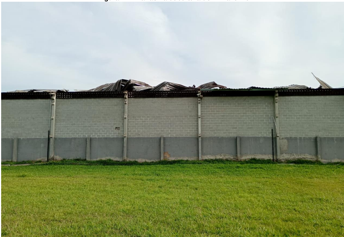
Figura 1 – Avarias na cobertura do Armazém 6
