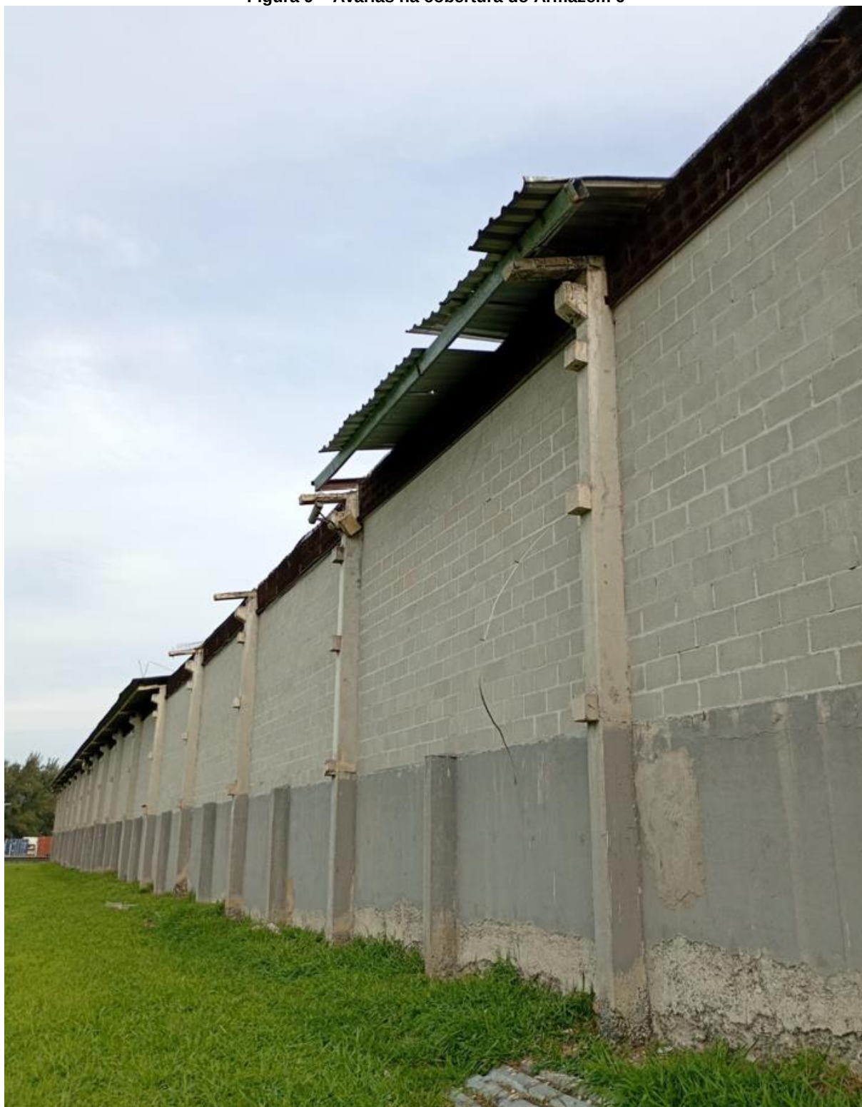
Figura 9 – Avarias na cobertura do Armazém 6
