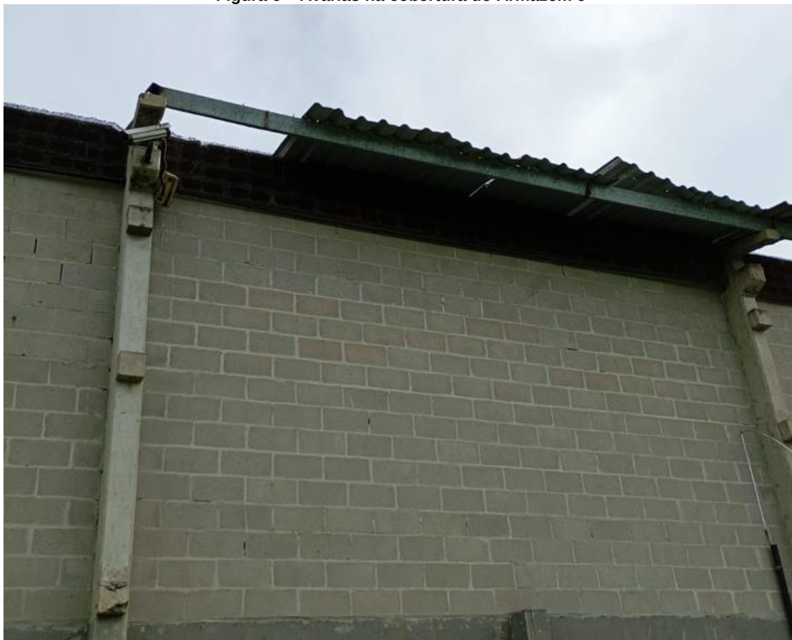
Figura 6 – Avarias na cobertura do Armazém 6
