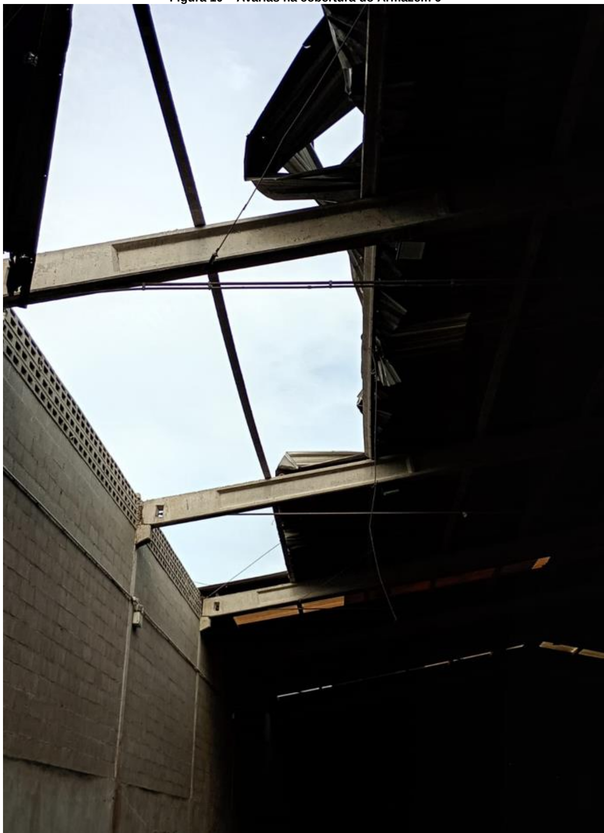
Figura 10 – Avarias na cobertura do Armazém 6
