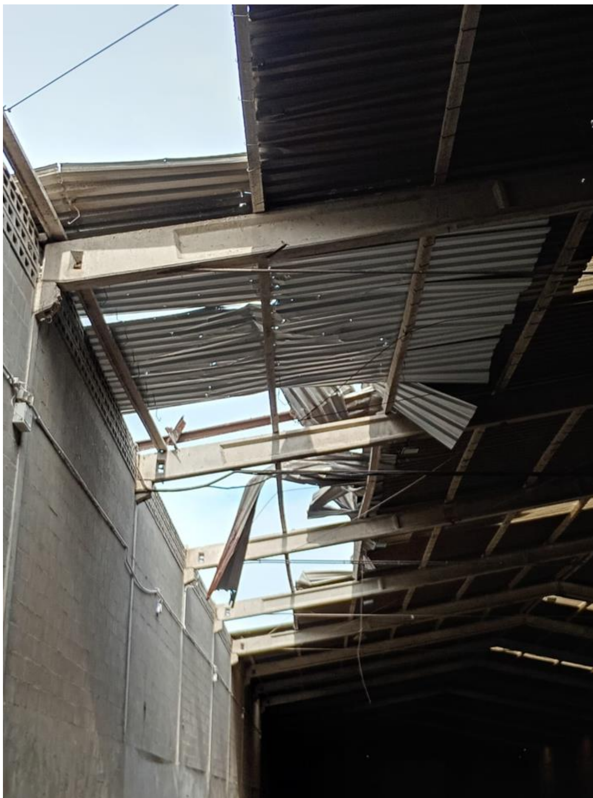
Figura 15 – Avarias na cobertura do Armazém 6
