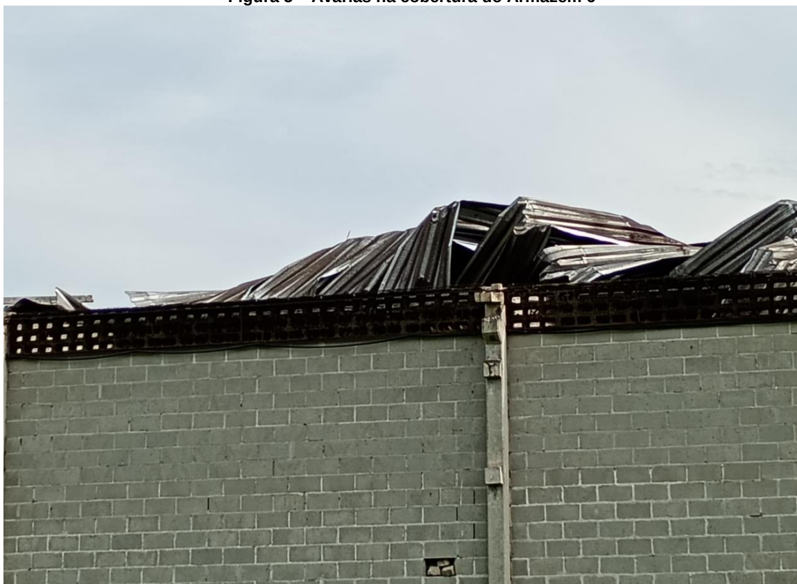
Figura 5 – Avarias na cobertura do Armazém 6
