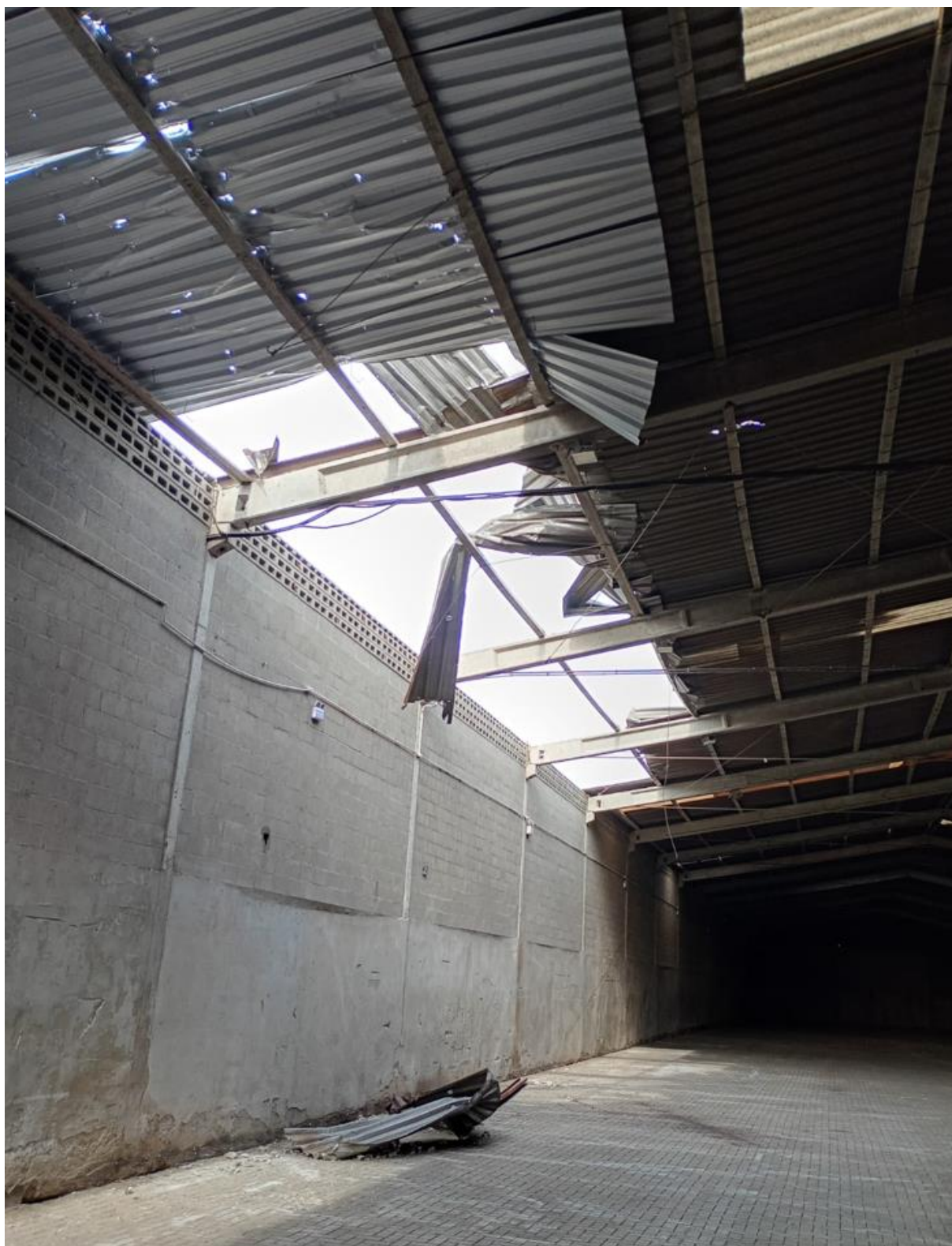
Figura 17 – Avarias na cobertura do Armazém 6
