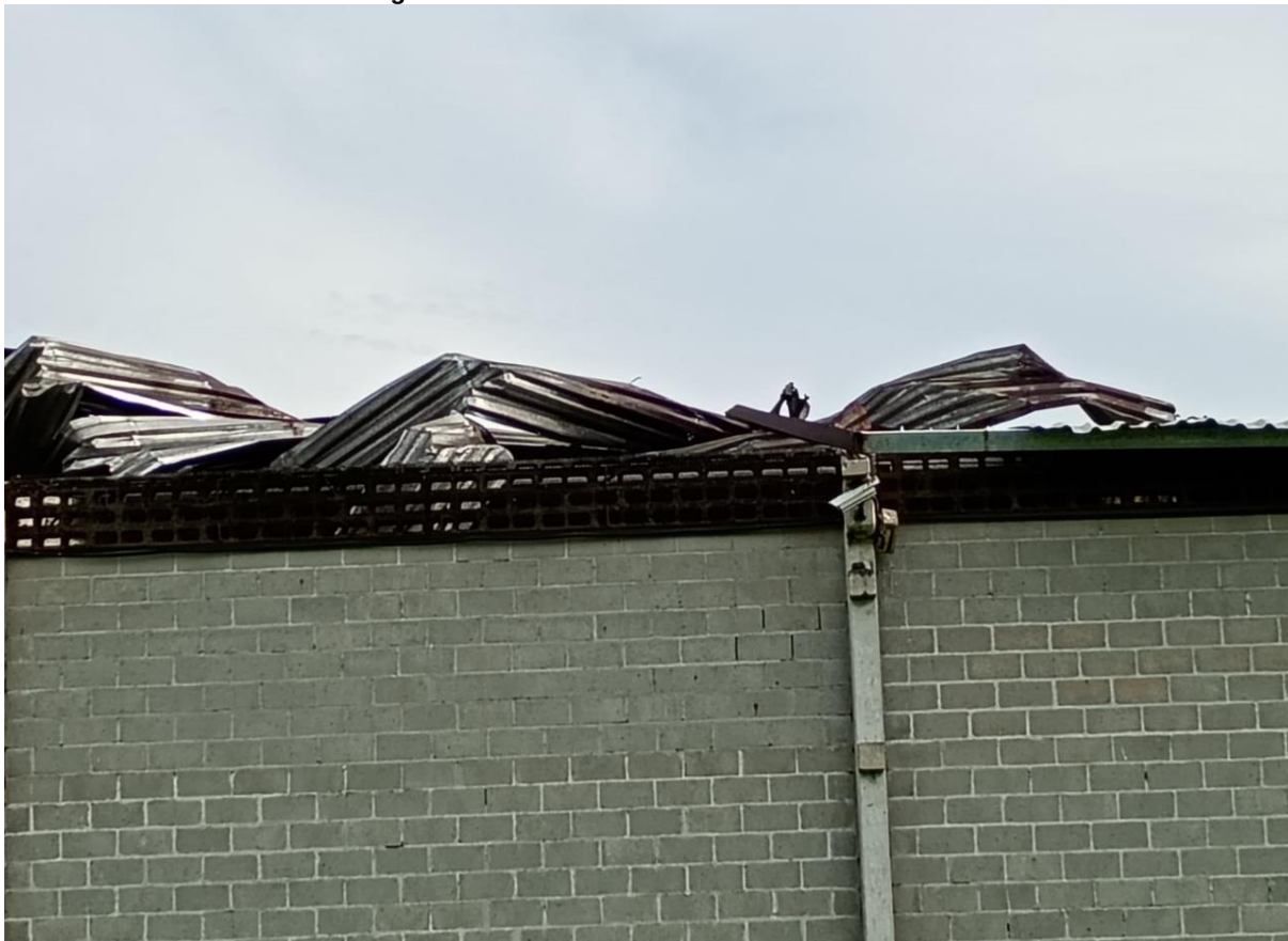
Figura 2 – Avarias na cobertura do Armazém 6
