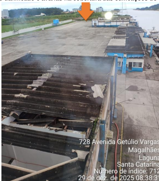
Figura 1 – Muro danificado e avarias na cobertura das edificações do Porto de Laguna
