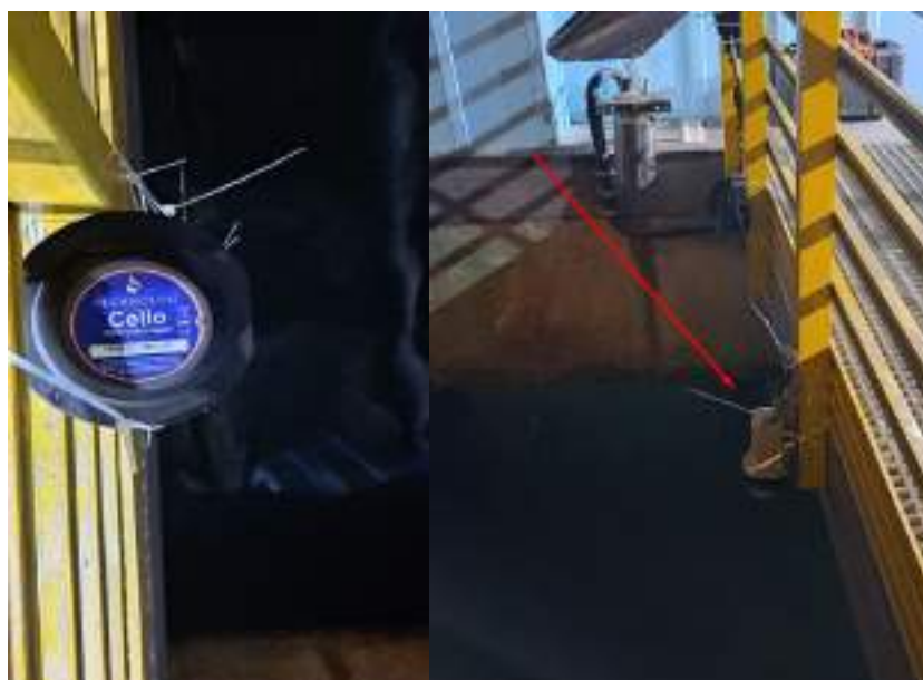
Figura 12 – Marégrafo Cello CSO instalado no cais do Porto de Imbituba.
