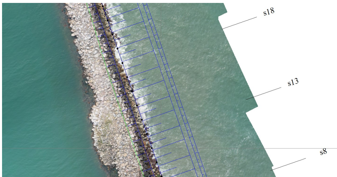
Figura 29 – Avarias de grande monta entre a seção 8 a 18.
