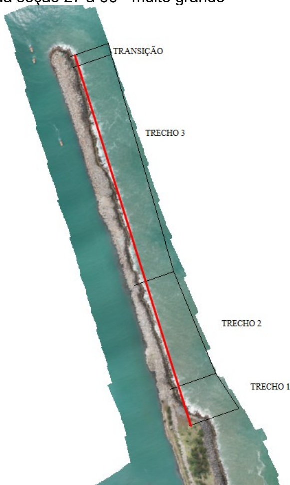
Figura 27 – Avarias de grande monta ao longo do molhe. Risco de rompimento.
