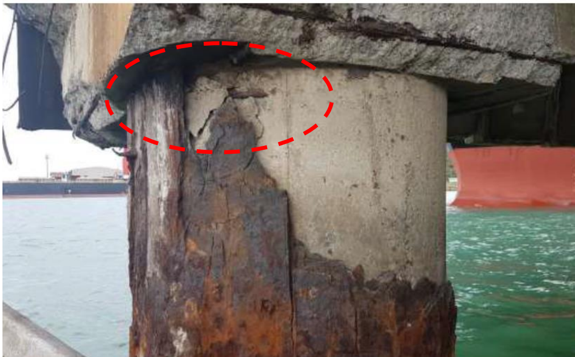
Figura 4 - Exemplo de Manifestação patológica de Nível 3 nas seções de concreto das estacas – (Deslocamento do concreto em região limitada, armadura de estribo exposta com oxidação).
