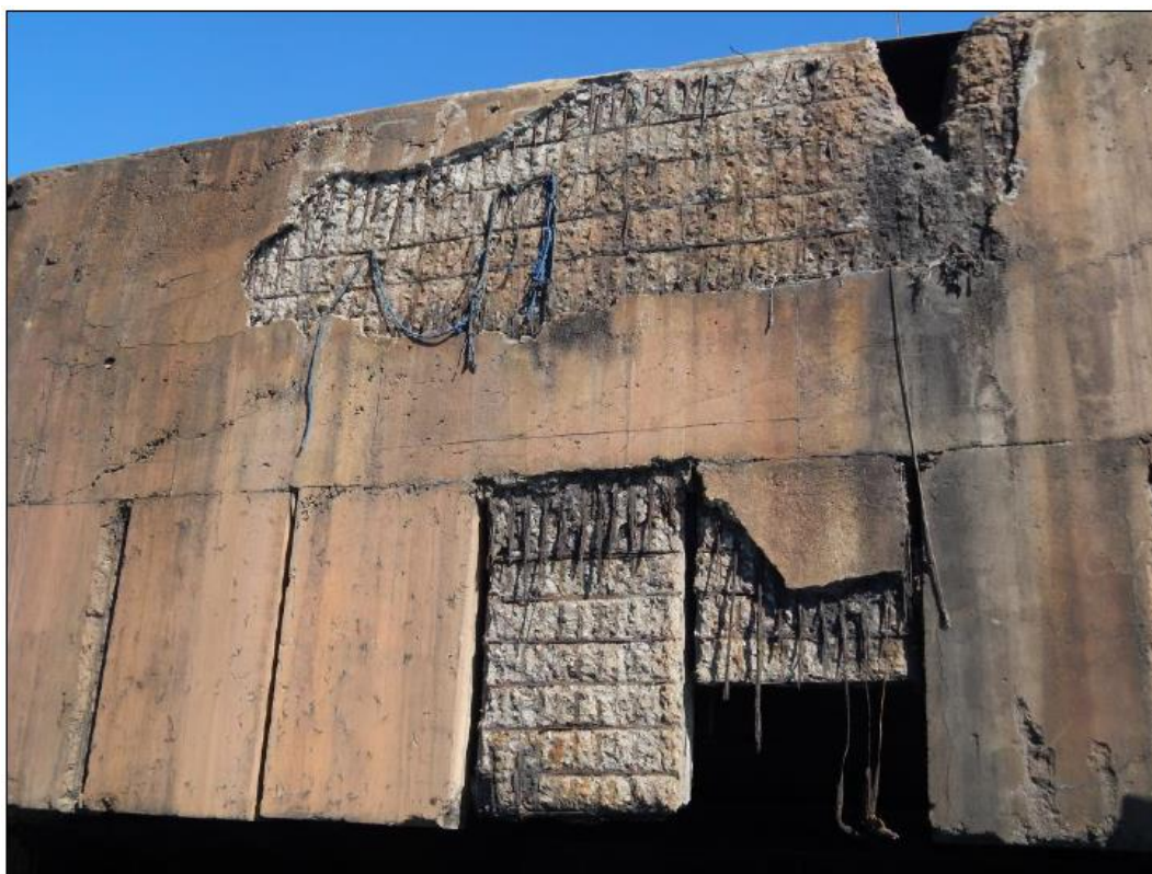
Figura 6 – Exemplo de Manifestação patológica de Nível 4 – (Armadura rompida ou exposta com perda de seção de 50% ou mais, perda da seção de concreto).
