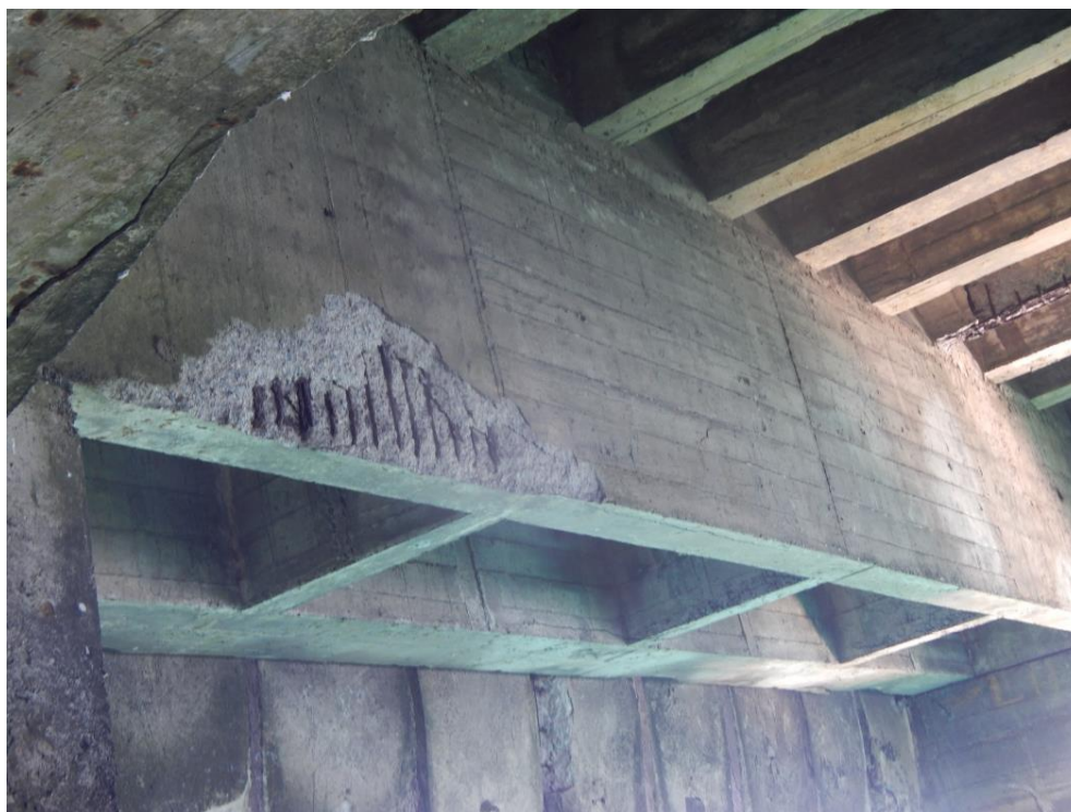
Figura 3 – Exemplo de Manifestação patológica de Nível 3 – (Deslocamento do concreto em região limitada, armadura de estribo exposta com oxidação).
