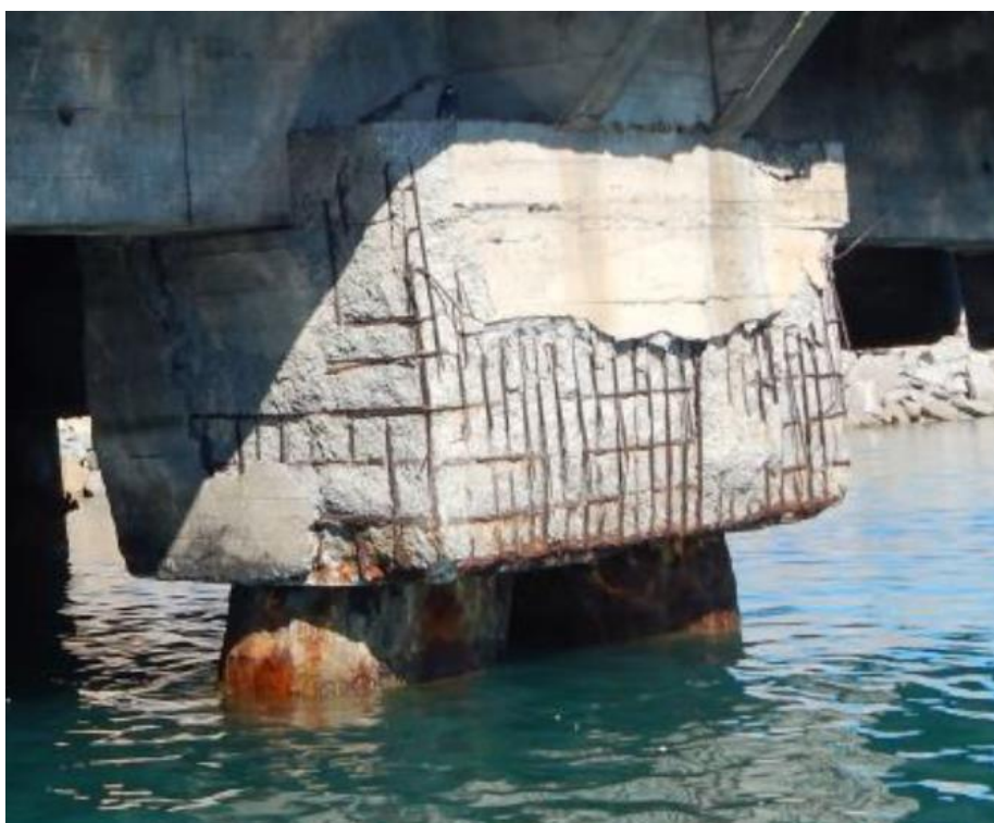
Figura 5 – Exemplo de Manifestação patológica de Nível 4 – (Ampla desintegração da superfície de concreto, oxidação grave das armaduras com presença de trincas).
