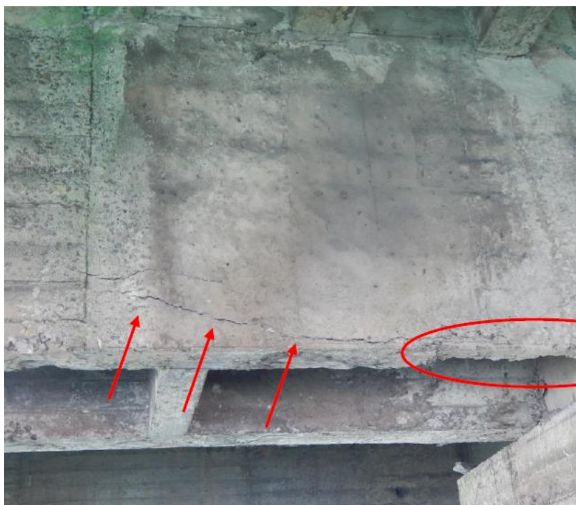
Figura 2 – Exemplo de Manifestação patológica de Nível 2 – (Presença de fissuras e manchas leves de oxidação)
