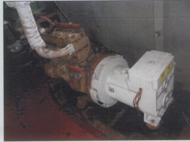
Foto 36- Diesel Gerador de emergência MWM/WEG.
