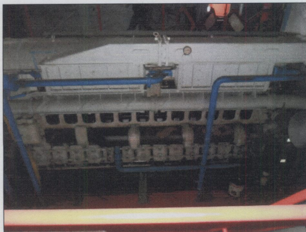
Foto 29- Motor diesel da bomba de dragagem.
