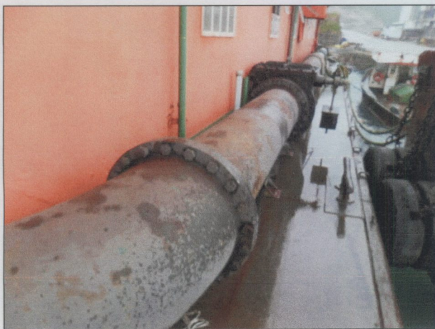
Foto 5- Vista da tubulação de descarga.
