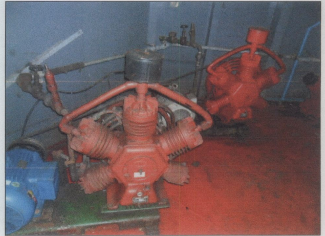
Foto 38- Compressores de ar.
