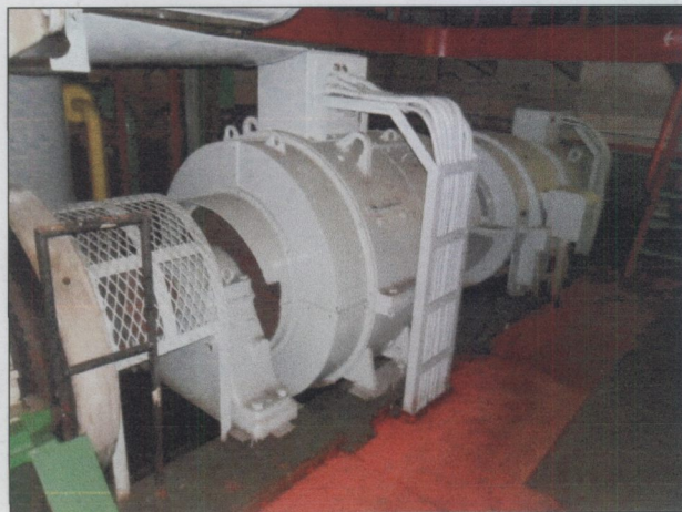
Foto 33- Geradores Principais de CC e CA.
