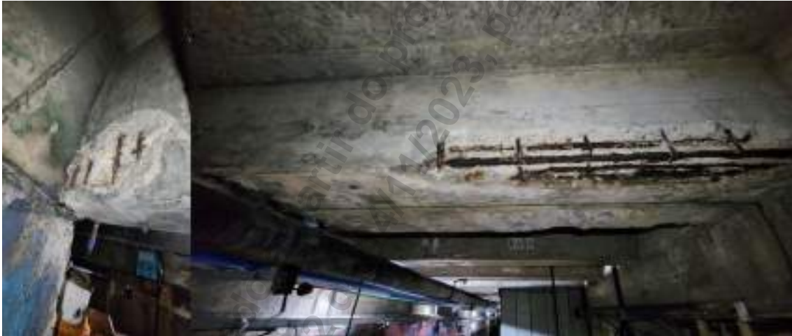
Figura 2: Imagens de algumas patologias encontradas nas estruturas.
