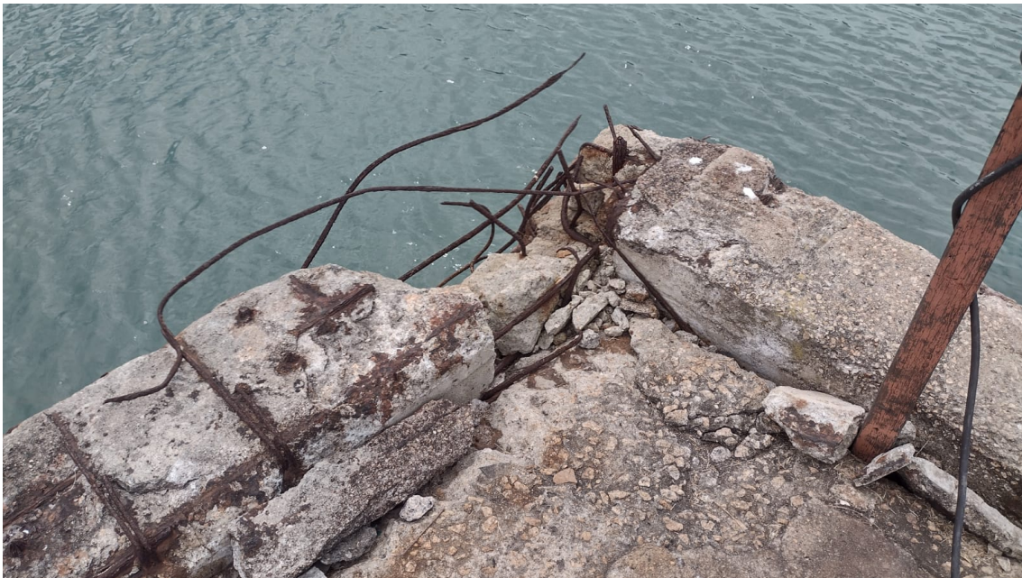
Figura 08 - Descolamento do concreto e armadura exposta.
