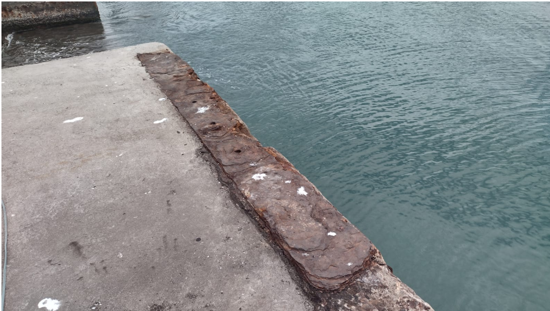
Figura 09 – Viga deteriorada do Cais 4.
