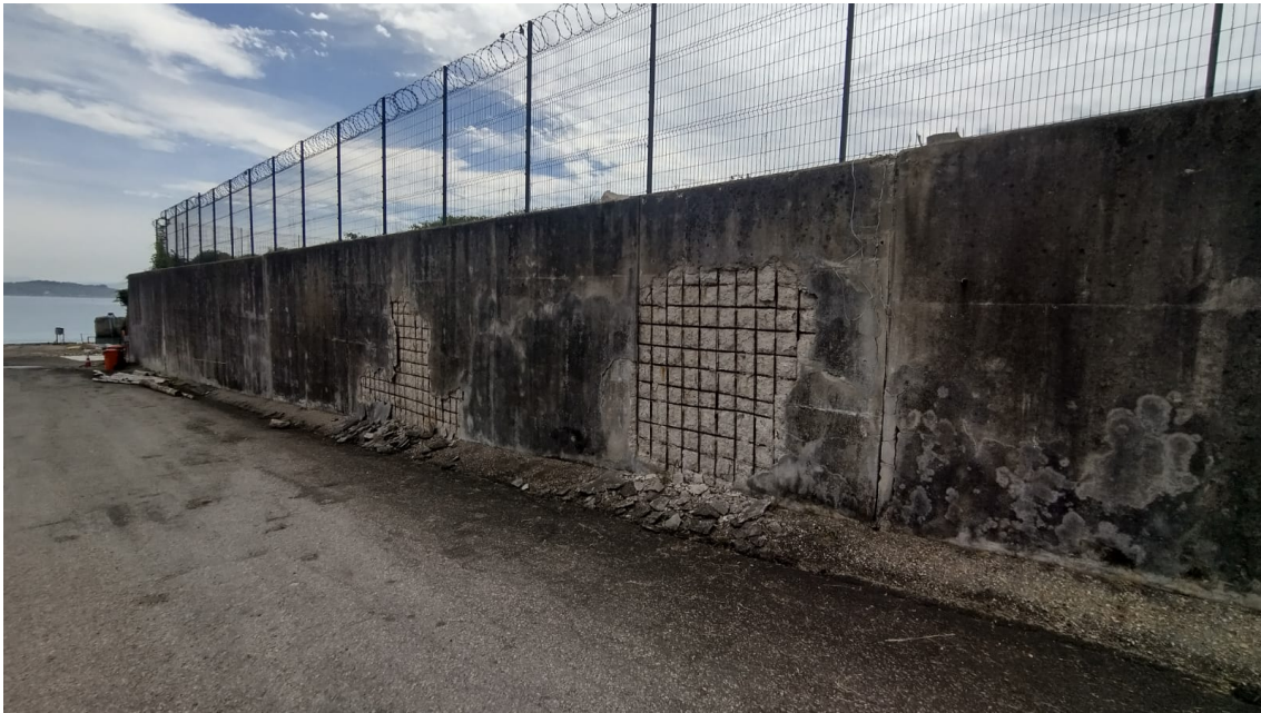
Figura 05 – Armaduras expostas no muro de contenção do Cais 4.
