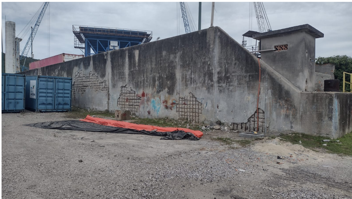
Figura 10 – Armaduras expostas no muro de contenção do Cais 4.
