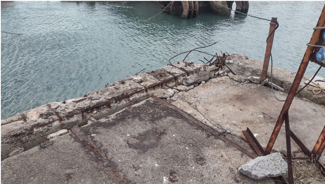
Figura 07 – Descolamento do concreto e armadura exposta.
