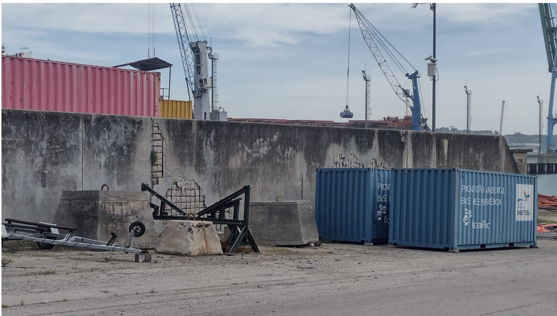
Figura 06 - Armaduras expostas no muro de contenção do Cais 4.
