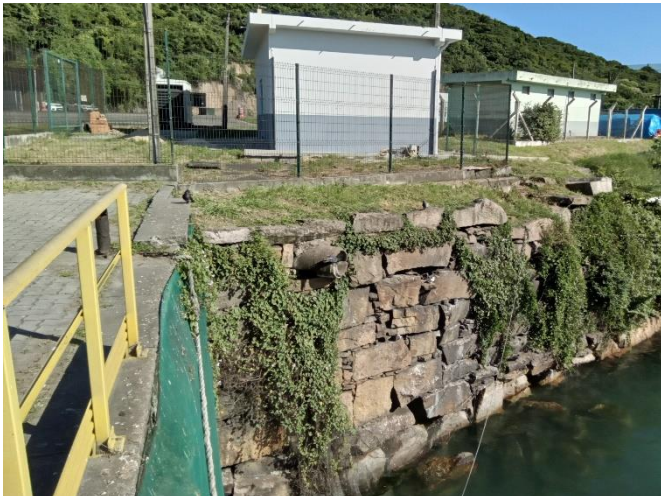
Figura 7. Paredão do cais 1 com vãos onde os pombos nidificam.
