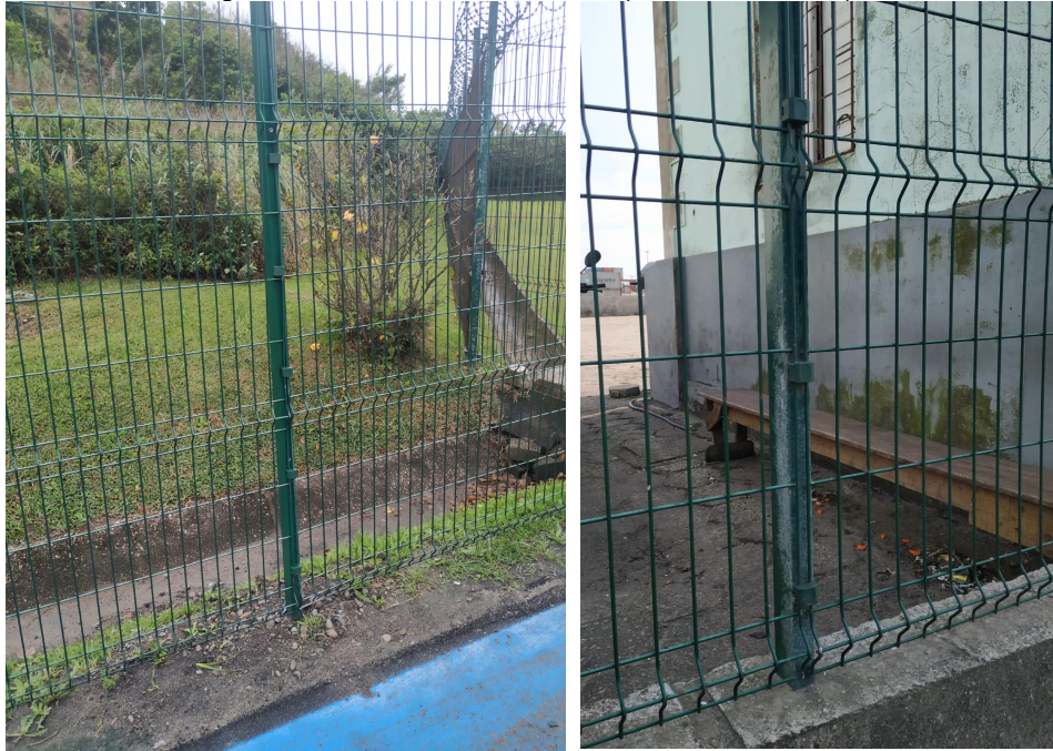
Figura 07 – Detalhe dos montantes (Novo e danificado)
