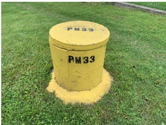
Foto 1: Visualização do acabamento externo do poço de monitoramento.
