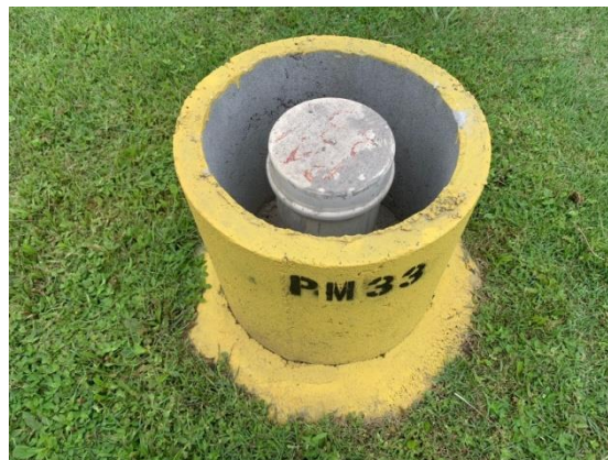
Foto 2: Visualização do acabamento interno do poço de monitoramento.
