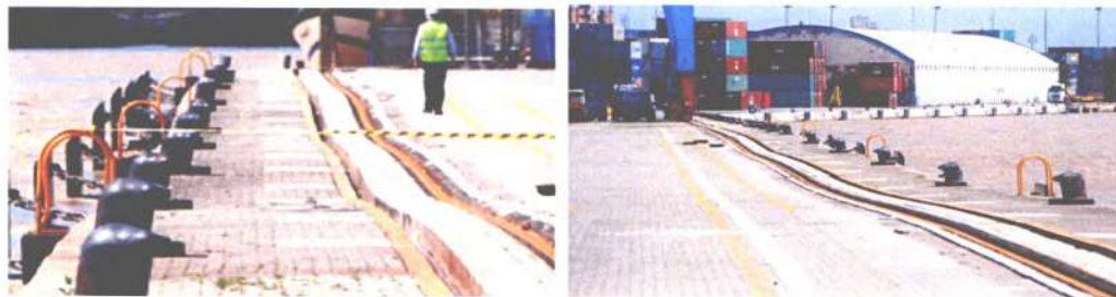
Figura 2 - Deformações no berço APMT 1 em 10/2011
