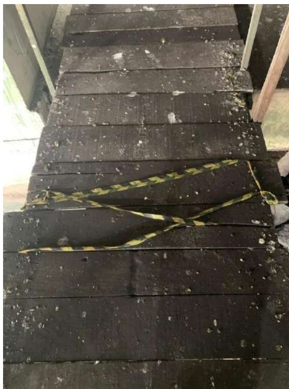
Figura 02 – Comprometimento da estrutura de reforço central
