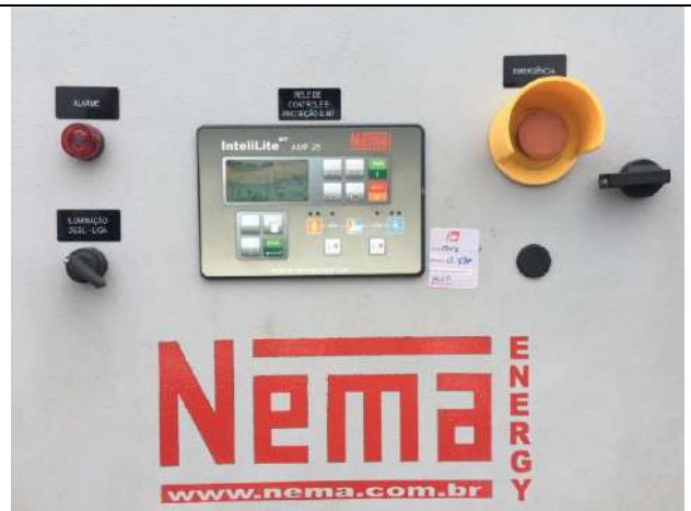
Figura 129 - Painel do gerador com botão de emergência. Fonte: Acervo próprio.
