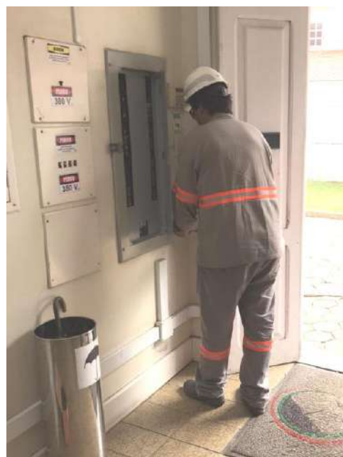
Figura 139 - Manutenção Preventiva Quadros Elétricos. Fonte: Acervo próprio.
