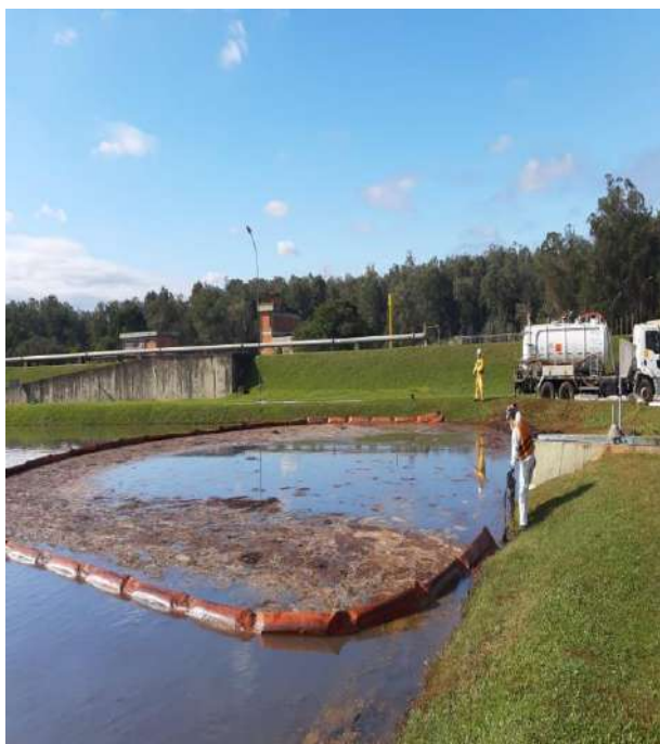
Arraste da barreira de contenção
