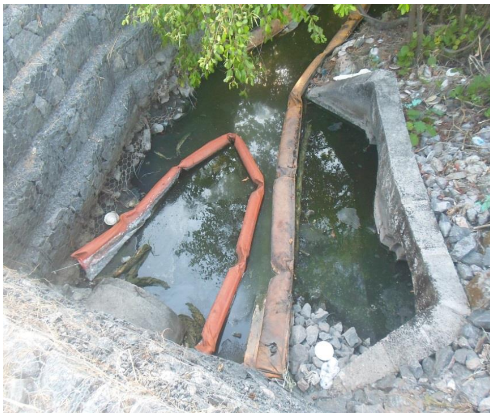
Foto 3.52: Vistoria no canal da Bungue (03/11/19).
